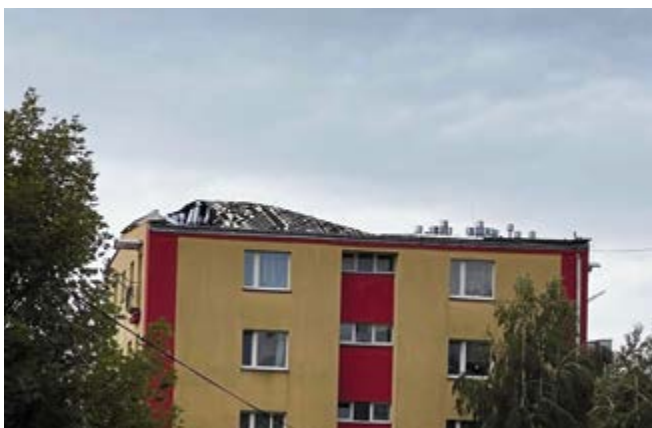
Skala zniszczeń po lipcowym huraganie
